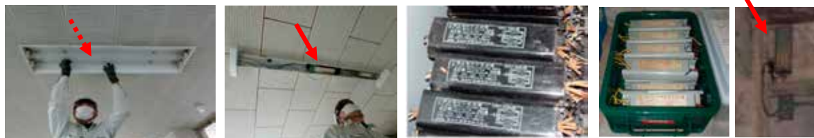
照明器具の安定器
